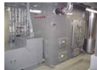
ペレットボイラー (介護老人保健施設内)
