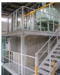
○木質ガス化施設(参考)
