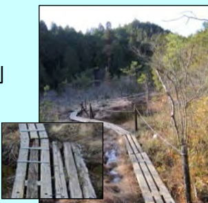
劣化の進行した木道
