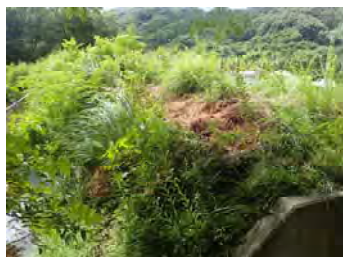
イノシシ等に荒らされた堤体
