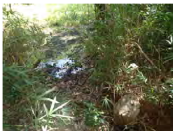
流木等の撤去がされていないため池洪水吐
