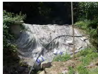
シートによる応急処置された堤体
