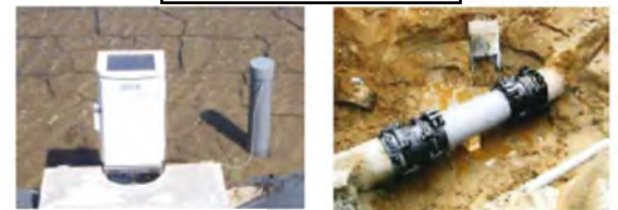
自動給水栓の導入
