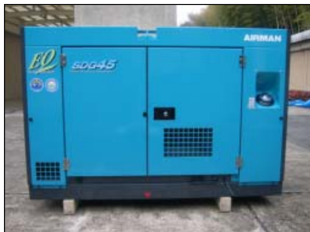
発動発電機 (45kVA)
