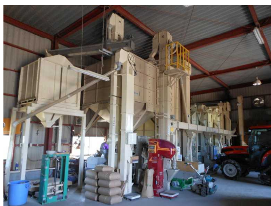
▽ 増設した乾燥機により乾燥調整に掛かる作業時間が短縮
