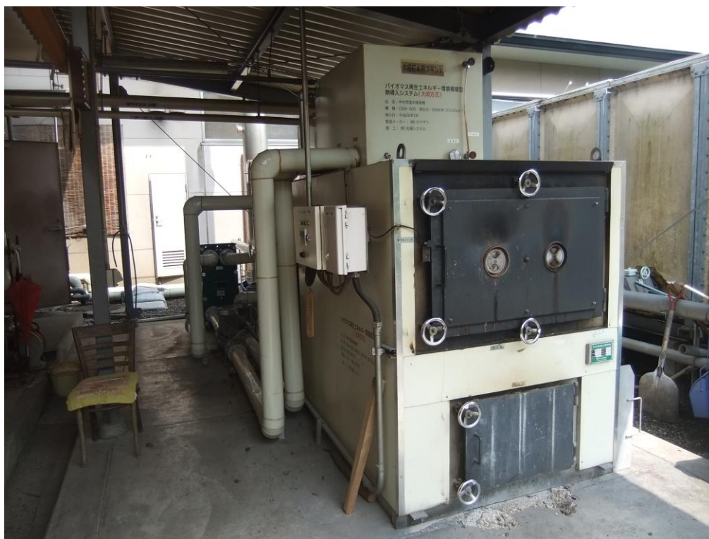
あすばる大崎 バイオマスボイラー
