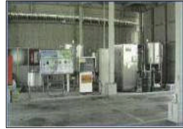
【BDF 製造設備】
