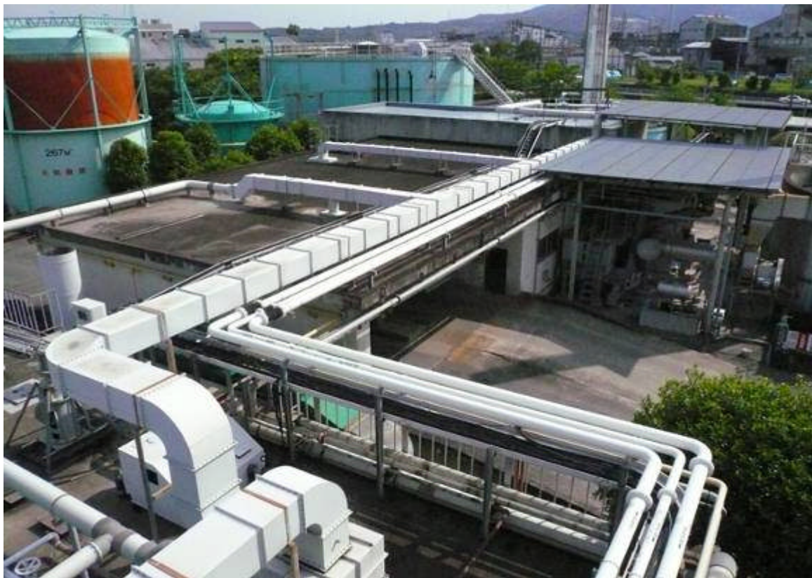
宇城広域連合浄化センター 浄化施設
