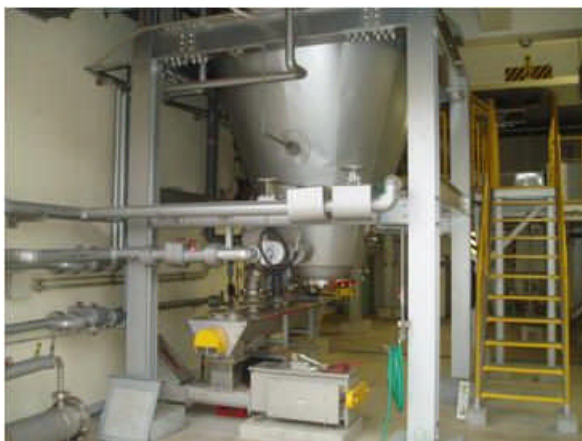
写真2 汚泥真空乾燥装置
