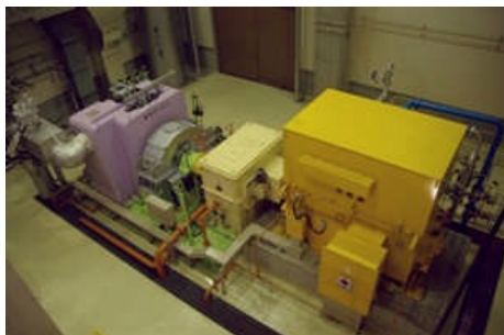
佐賀市清掃工場発電機
