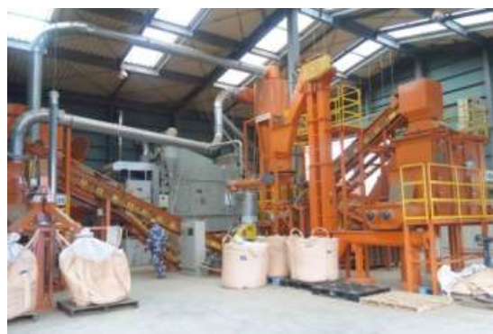
S 社の木質ペレット工場(小林市)
