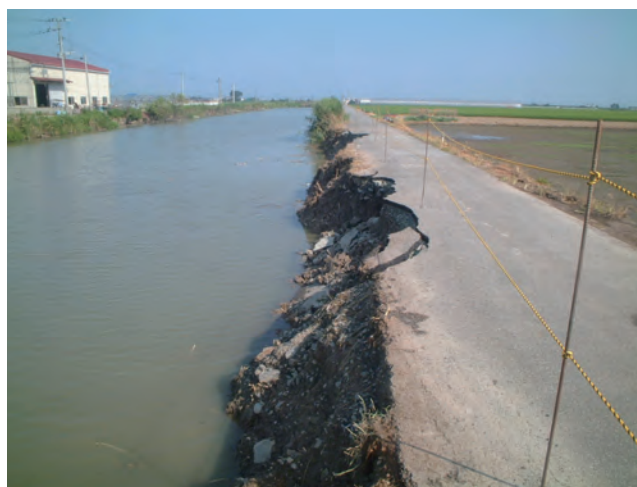
水路の法面崩壊の状況
