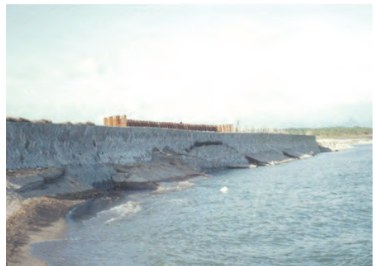
波浪等により被害を受けた堤防（鹿児島県大崎町菱田地区）
