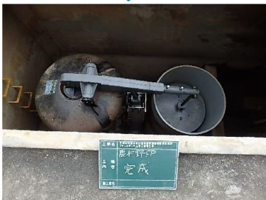
ディスクバルブ整備後 （油圧ダンパー取付による 止水機能の改善）
