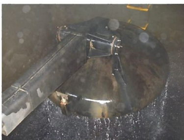
ディスクバルブ （止水不良による漏水状況）
