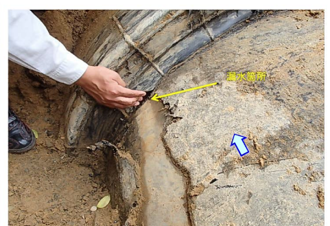
ゴム伸縮可とう管（漏水）
