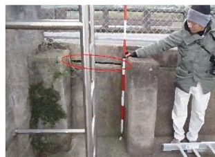
取付堤防護岸の状況 中詰材の吸出し、空洞化
