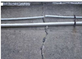
取付堤防擁壁 目地材のはみ出しによる剥離
