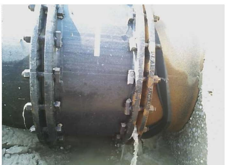
DCIP管（パッキンのめくれ出し）
