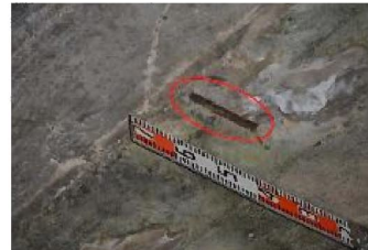
管理橋 地覆下面の鉄筋露出状況
