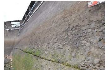
取付堤防擁壁 摩耗による骨材の露出
