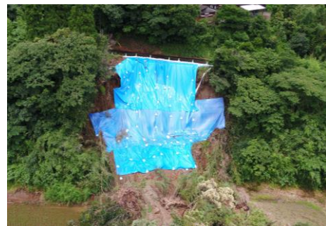
〔 管理設箇所道路路面崩壊 曾於南部地区（鹿児島県） 〕
