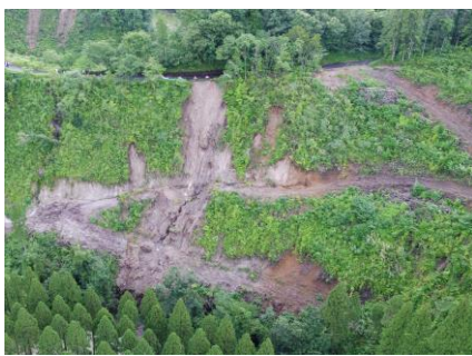
〔 管理用道路路面崩壊箇所 曾於南部地区（鹿児島県） 〕
