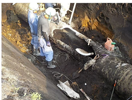
幹線水路漏水状況
