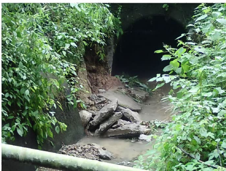
被災状況 (被災箇所②)
