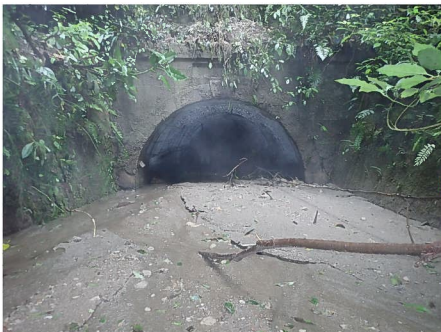
被災状況 (被災箇所①)
