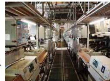
FA工場内部
