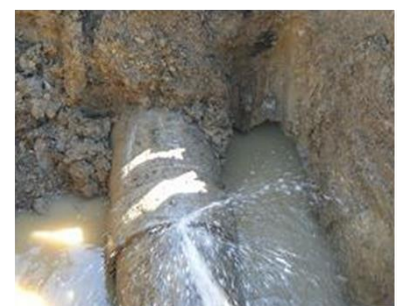
管水路からの漏水
