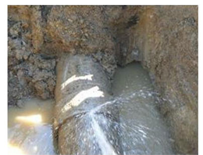
管水路からの漏水
