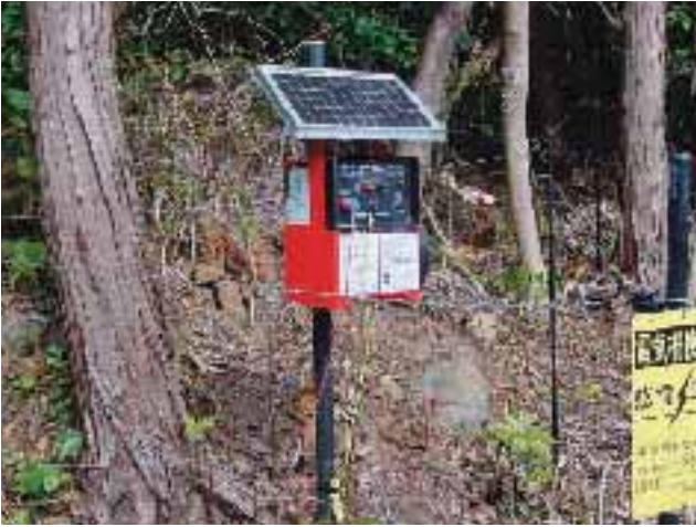
ソーラーパネル 通電していることも表示します。
