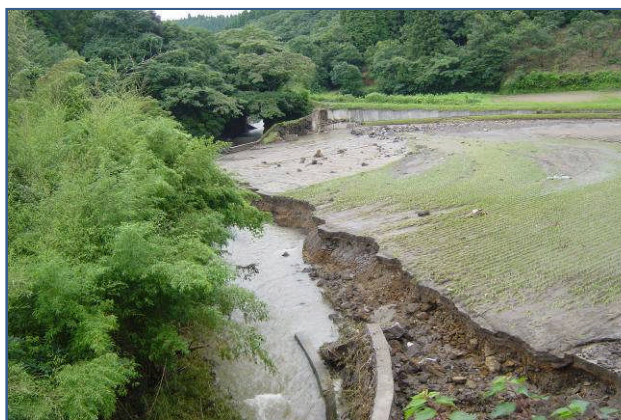
霧島市霧島町草場地区の河川から水田への土砂流入による被災状況、河川護岸も被災
