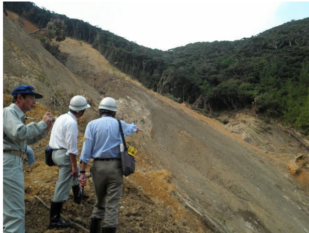
①農道(龍郷町瀬留地区①) 地質官より復旧工法等の助言を行う
