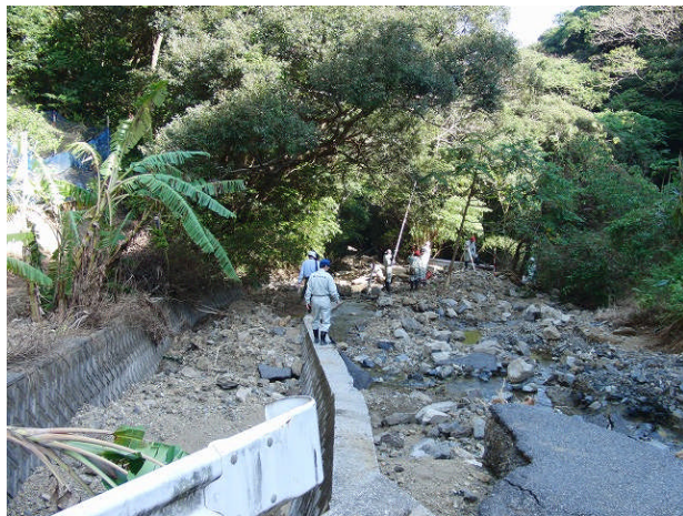
③農道(大和村大和地区) 河川上流からの土石流により崩壊 左側:河川 右側:道路
