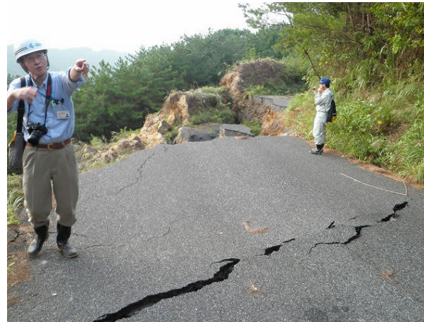
②農道(龍郷町瀬留地区②) 路面排水等により道路が崩壊
