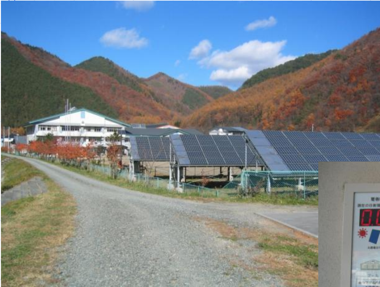
葛巻中学校太陽光発電設備(50kW)
