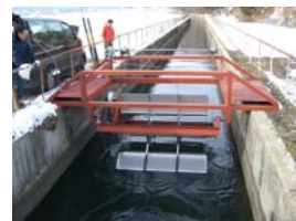
流水利用型発電機の設置状況
