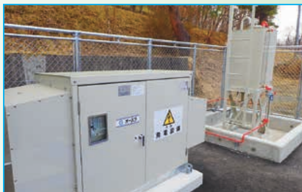
【非常用発電設備の整備（西郷、日中）】
