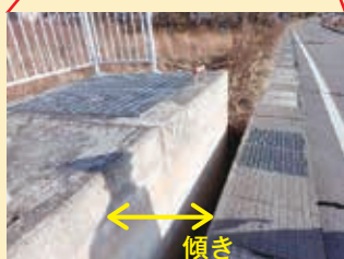
【排泥工柵の傾き】
