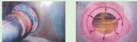
【中間ブッシュの破損】
