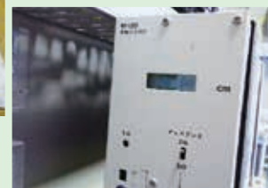
【水位計変換器（交換前）】
