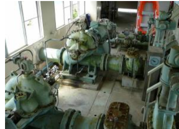
写真-3 八栄島第2用水機場ポンプ
