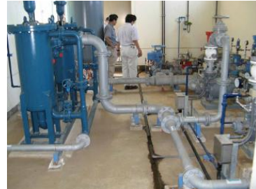
写真-3 第7加圧機場内部
