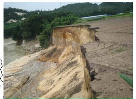
農地の流失被害
