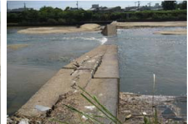
三重県津市 頭首工 崩壊
