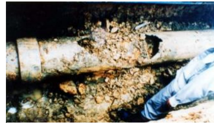
石綿管破損状況
