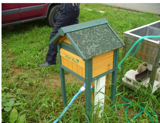
農園内に引き込んだ上水道
