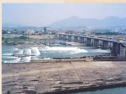
犬山頭首工 河床低下状況(平成8年)
