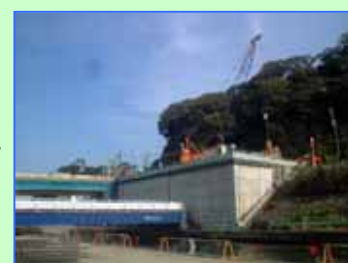
既設操作室の取り壊しを終え新たな基礎工事をしています
