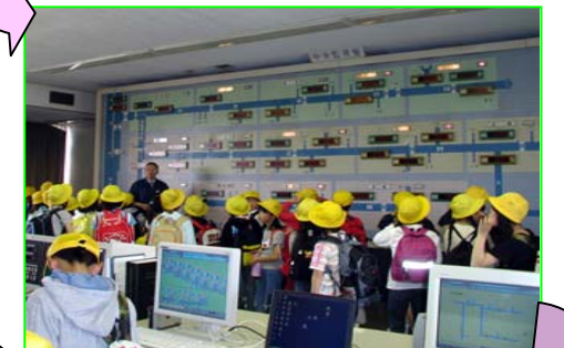
操作室の中にはいろいろな水路の水量を確認できる大きなパネルがありました。
