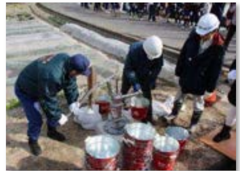
防災兼用井戸の整備
