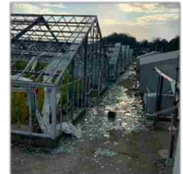
被災したガラスハウス (2019年房総半島台風)
