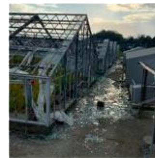
被災したガラスハウス (2019年房総半島台風)
