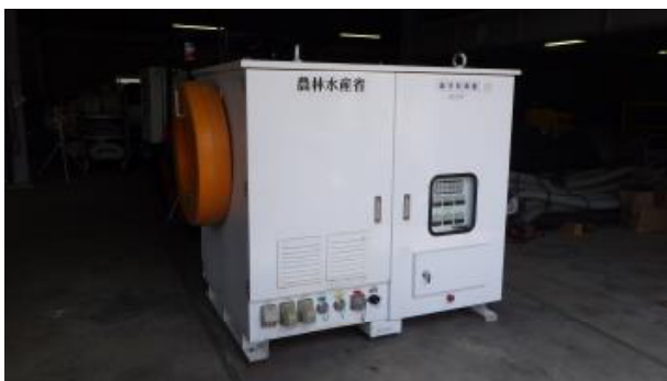
排水ポンプパッケージ（操作盤側）
