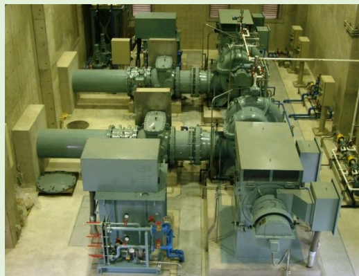
揚水ポンプ設備
