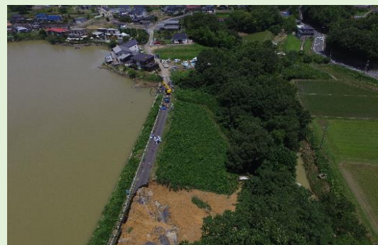
ため池堤体の被災状況 (平成30年7月豪雨)
