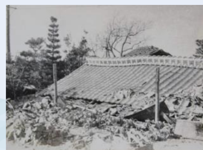
昭和南海地震で全壊した家屋 （写真提供：岡山地方気象台）
