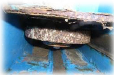
ゲート主ローラーの発錆、動作不良
