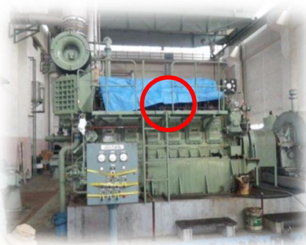
ピストンの損傷位置
