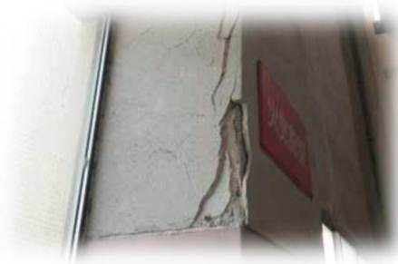
建屋内装材の剥離
