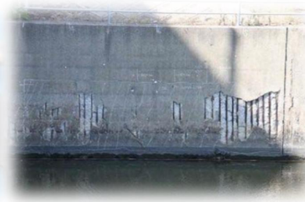
呑口導水路側壁の鉄筋露出
