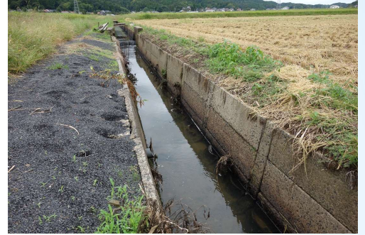
老朽化した排水路
