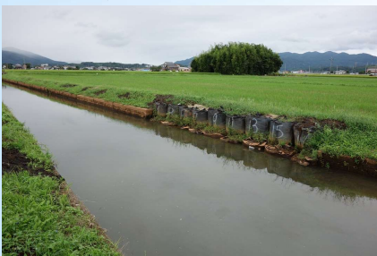
老朽化した幹線排水路
