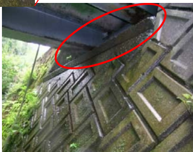
開水路(水路橋)継手部からの漏水
