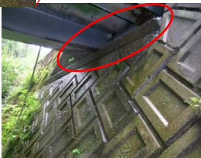
開水路(水路橋)継手部からの漏水
