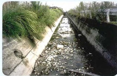
▶ 地区内水路のゴミ混入状況
