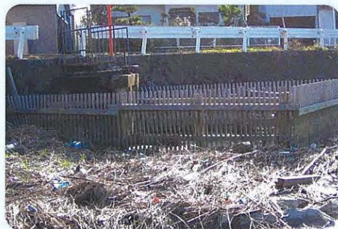
▶ ゴミが集まった樋門付近の様子
