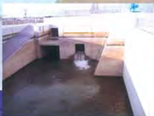
水量調整水槽： 鳴門市大麻町
