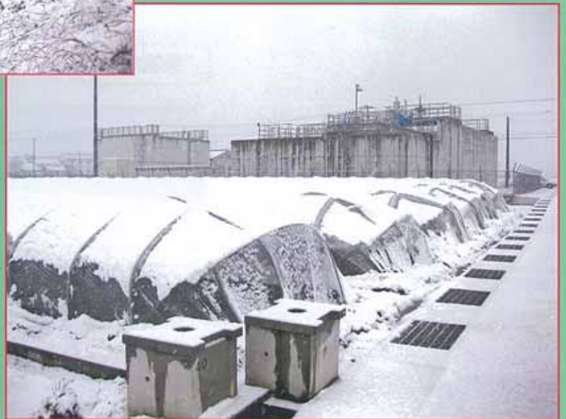
南部幹線水路1号水位流量調整施設：上板町佐藤塚
